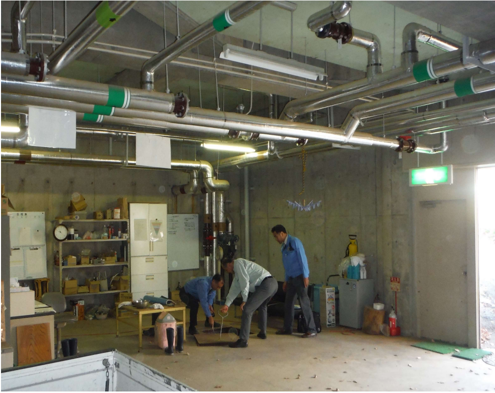
写真①(ヒートポンプシステム全景) 工事前
