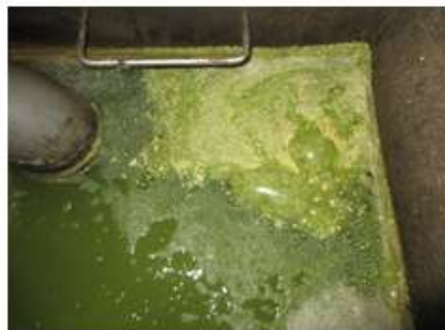
排水槽内浮遊物
