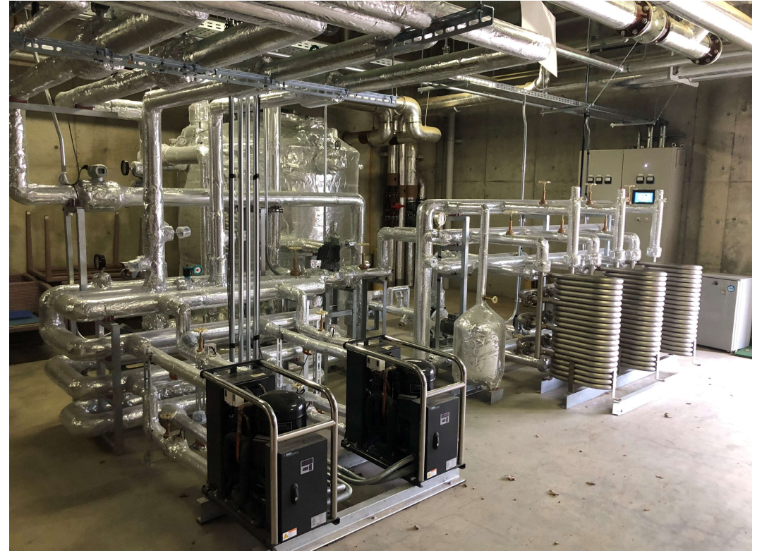
写真②(ヒートポンプシステム全景) 完成
