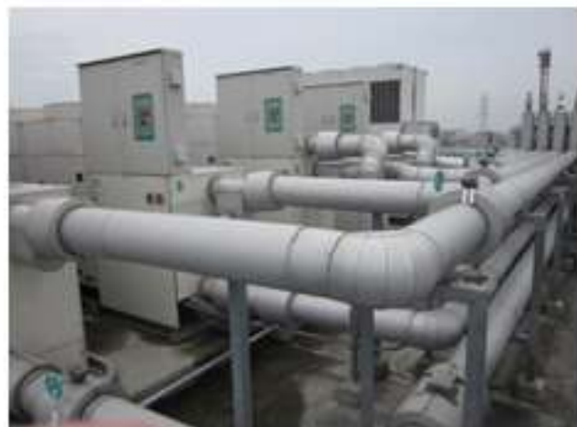
屋上既設チラー
