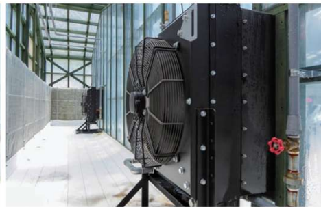
◀左： 輻射熱・気化熱発生装置 ◀中央： 除湿ファン ◀右： 機械室（ファン及び一部配管）
